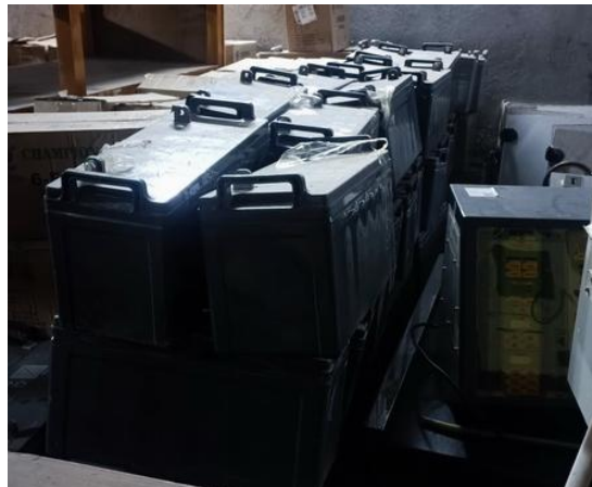
06923&06924-UPS 电池组 (64+32 节)
